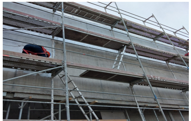
Quemado con ácido y aplicación de pintura en muro exterior eje 19a/L-Y1, fachada poniente.
